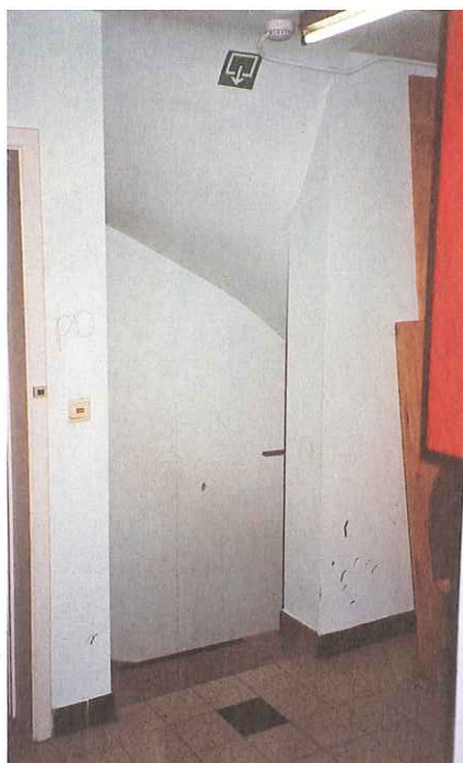
Photo 4: La cage d'escalier ouverte est équipée d'un détecteur de fumée et d'un pictogramme.
