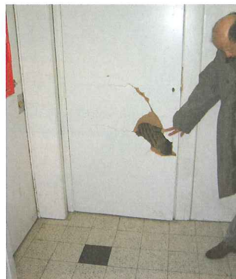
Photo 8: Une des portes en carton pressé des deux gaines pour les canalisations de gaz naturel et d'eau et pour les câbles électriques sur le palier commun.
