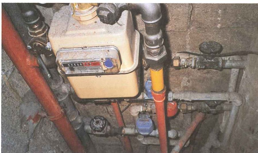
Photo 6: Gaine verticale ouverte pour les canalisations de gaz naturel et d'eau.
