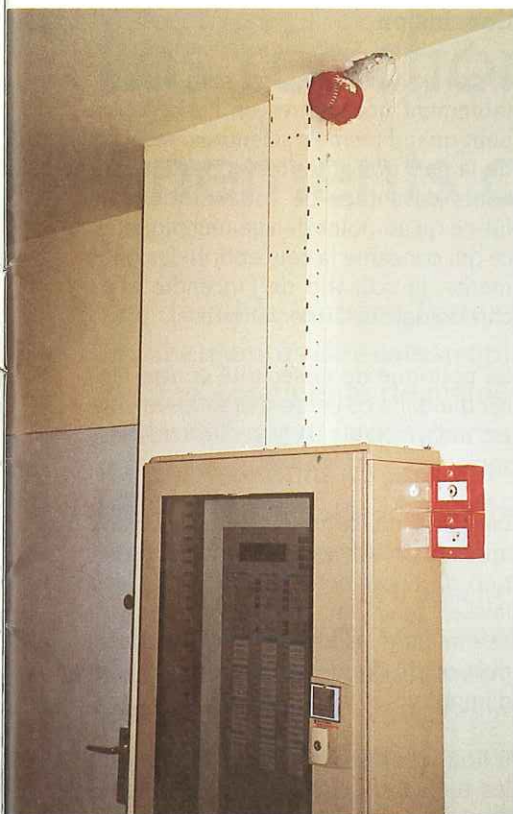
Photo 9: Le central de détection avec les boutons-poussoirs et les sirènes d'alarme électronique est situé au rez-de-chaussée.
