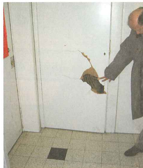
Foto 8: Een van de deuren uit hardboard van de twee kokers voor aardgas, water- en elektriciteitsvoorziening op de gemeenschappelijke overloop.
