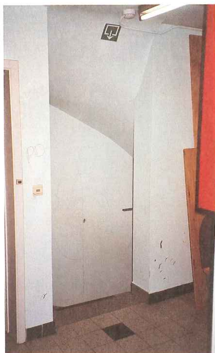
Foto 4: Het open binnentrappenhuis is uitgerust met een rookdetector en voorzien van een pictogram.
